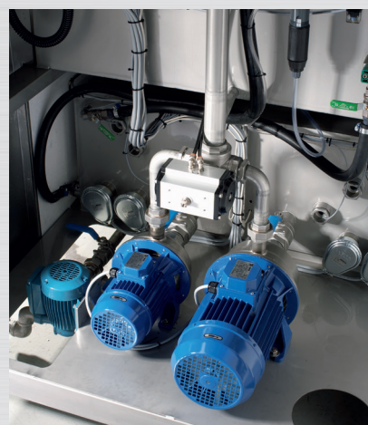
Nem adgang til anlægget, pumpeenheder m.v.
